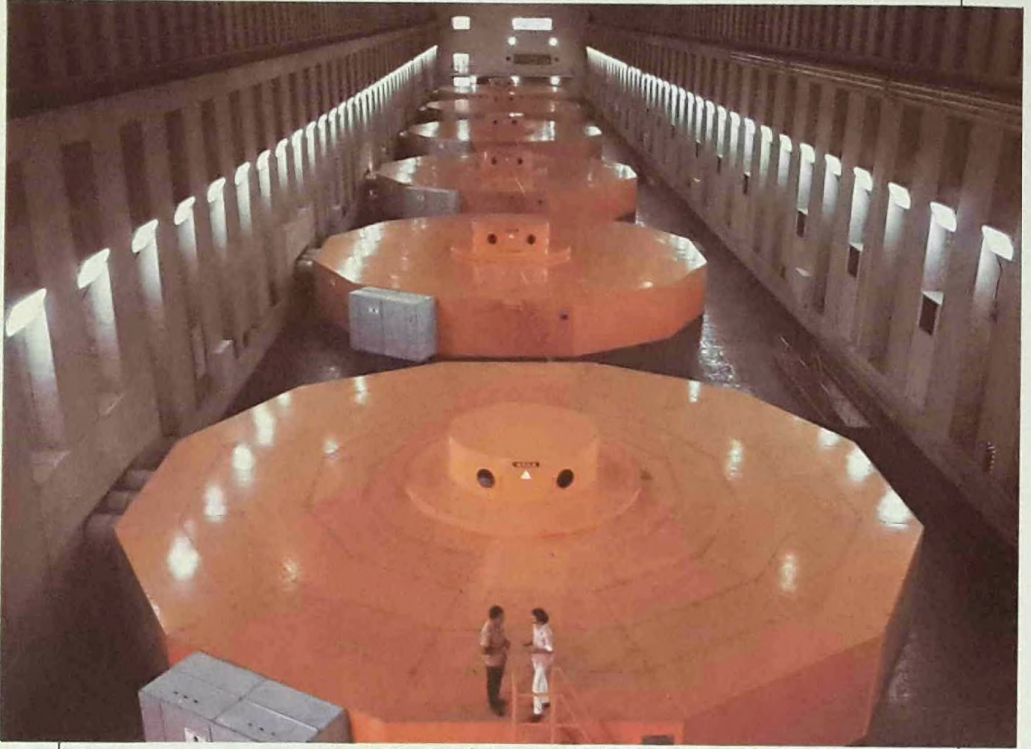
محطة الكهرباء - مركز المولدات العنيفة في إحدى المحطات الكهرمائية.
